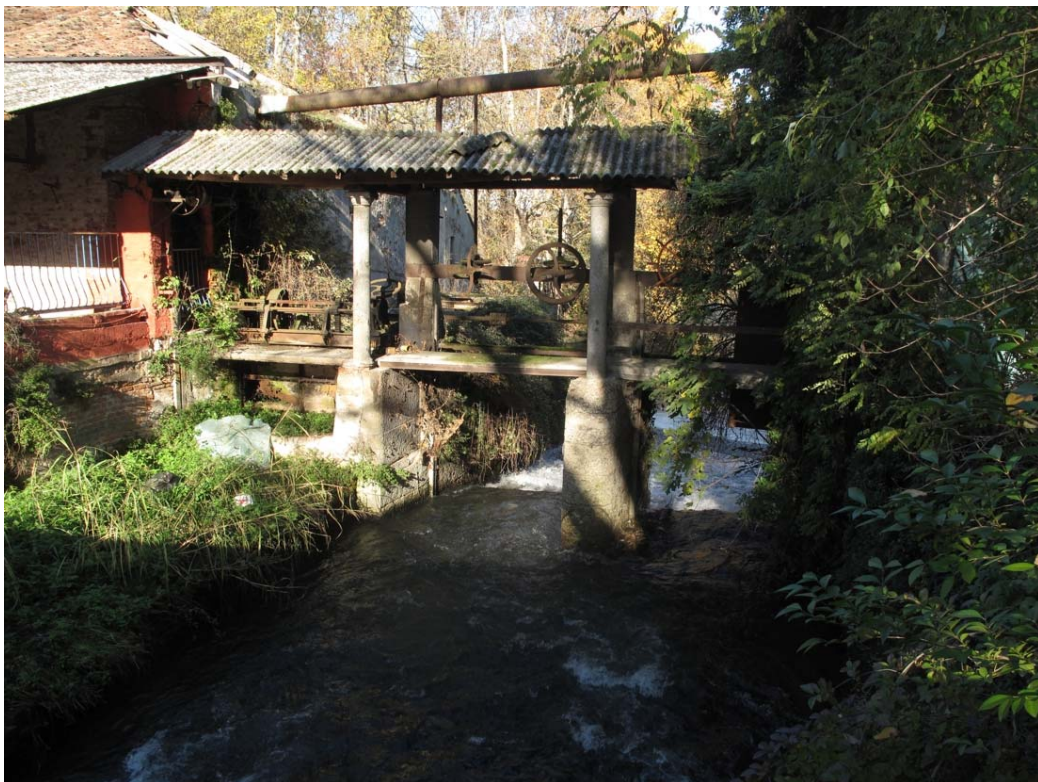
Foto 1_06 – opere di regimazione delle acque della R. Vettabbia, chiuse in disuso (presso Molino della Valle)
